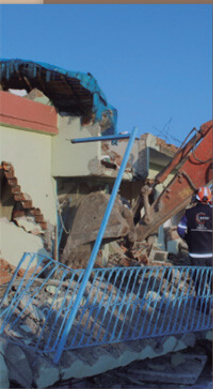
Comercio dañado por terremoto en Capadocia, Turquía.
