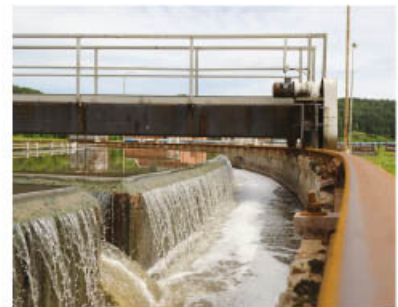
Figura 3.6. Planta de tratamiento de aguas residuales.
