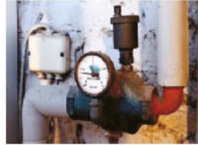
Manómetro conectado a una tubería.
