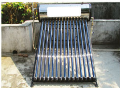
Figura 2.95 Usar calentadores solares de agua permite reducir las emisiones de gases de efecto invernadero, y también contribuye al ahorro económico al no consumir combustibles, como el gas LP (licuado del petróleo).
