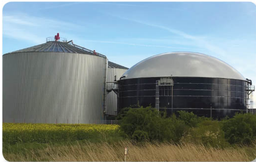
Figura 1.63 El metano producido en esta planta de biogás se obtiene de los procesos biológicos de degradación, por microorganismos, de la materia orgánica.
